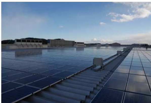
■PLANT-5大玉店の屋根に設置した太陽光パネル
