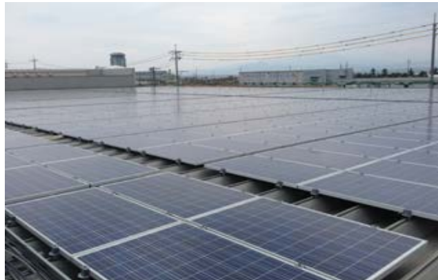
■PLANT-5境港店の屋根に設置した太陽光パネル
